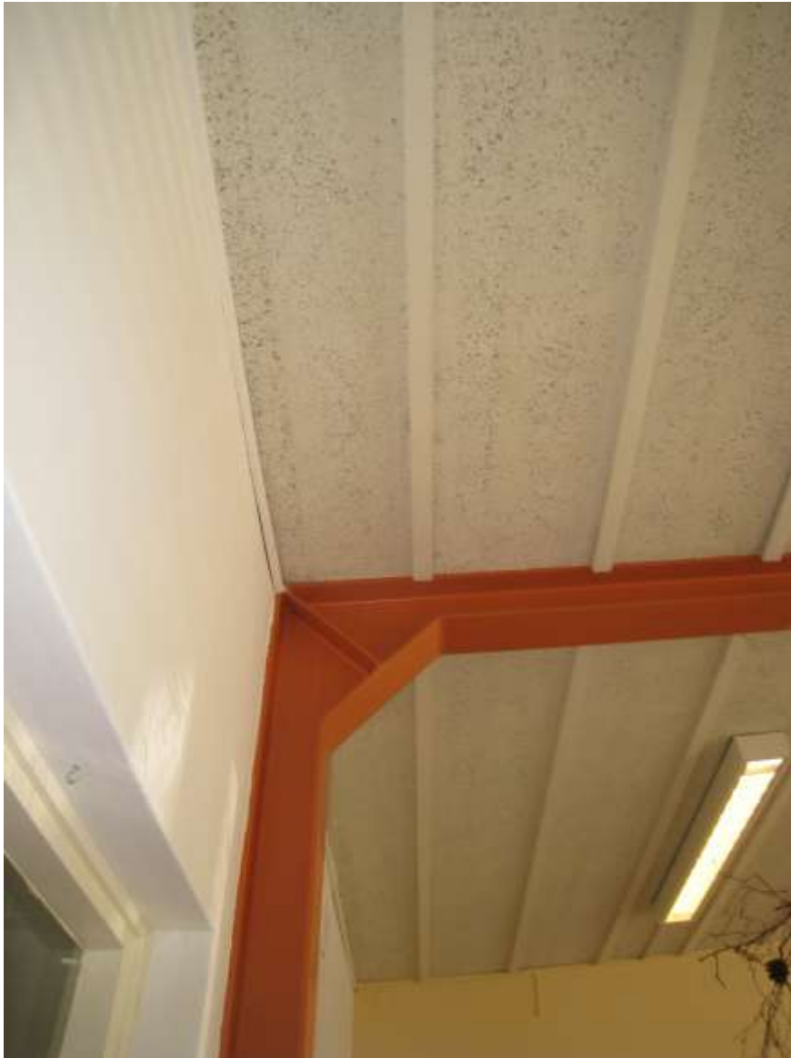
Afb. 48 Stalen spant in een lokaal
